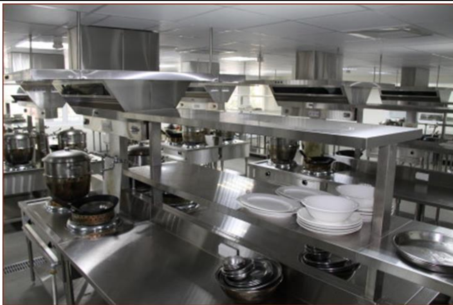
中餐一教室-爐台設備
